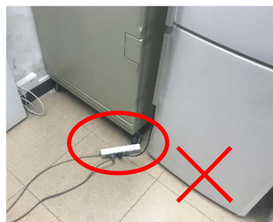
图 2. 长期使用的仪器应使用 固定插座，严禁乱拉电插板
